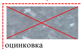
рис. 2.25 «недопустимый вид внешний вид финишного покрытия»
